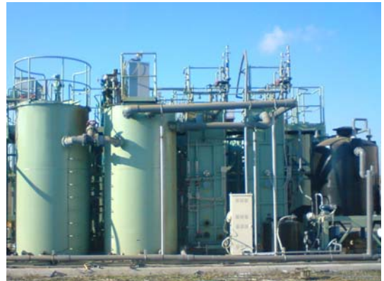
写真-1 実証プラント全景
