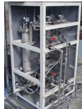
写真-1 VPSAシステム吸着塔外観
