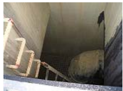
写真 2 圧送開放部人孔現況
