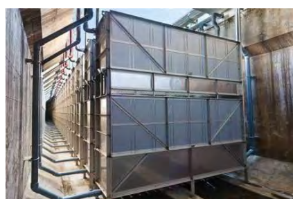
膜ユニットの設置状況例
