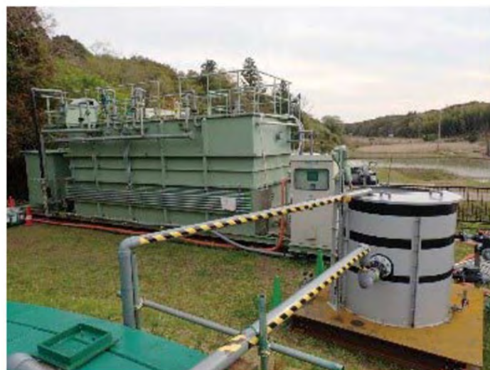
単槽式MBRユニットの設置状況例
