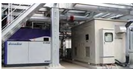
スクリー式蒸気発電機(左)とバイナリ発電機(右)
