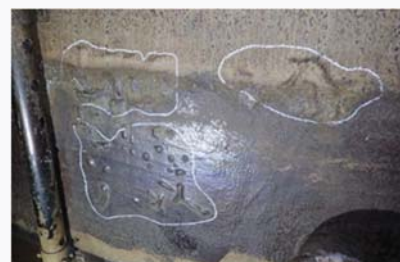
有機酸による劣化の可能性のある事例 （濃縮汚泥槽）
