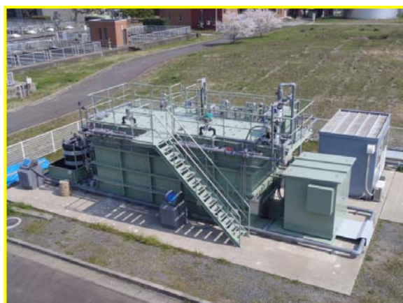
写真1. 実証試験装置の外観写真
