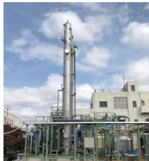
▲バイオガス精製装置
