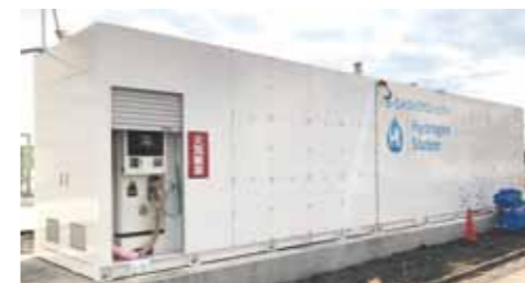
▲水素供給装置
