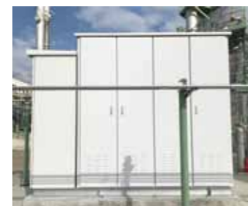
▲水素製造装置
