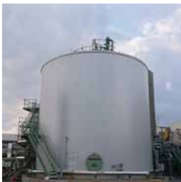
▲高濃度消化槽
