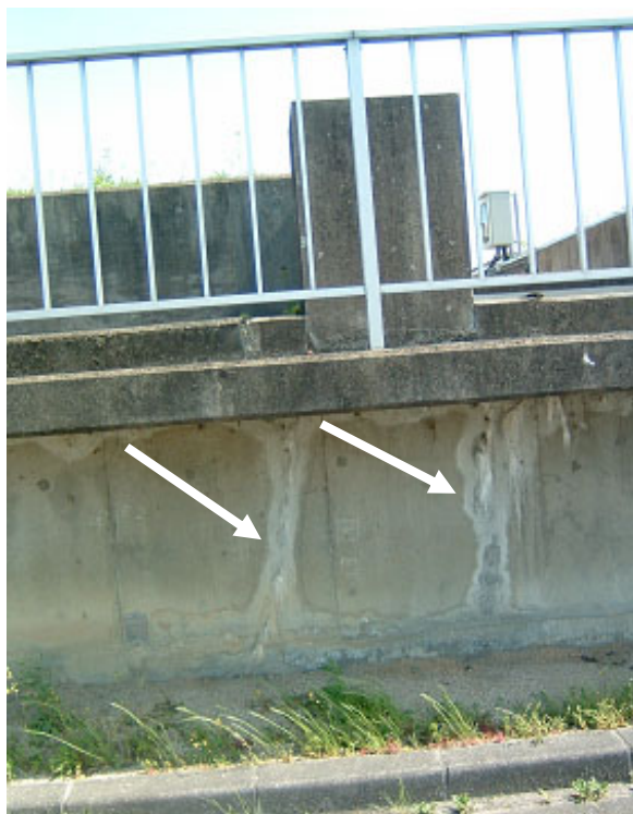
写真2 柱の両脇のひび割れと白華
