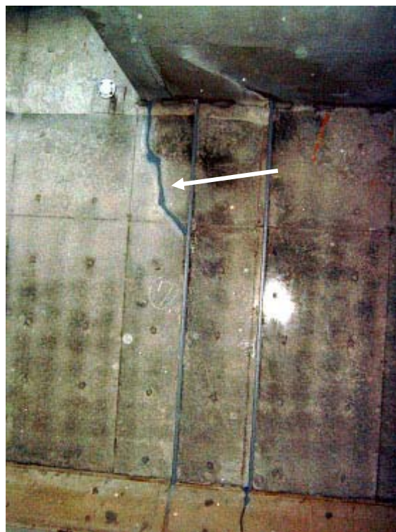
写真3 断面変化点のひび割れ(充填補修)
