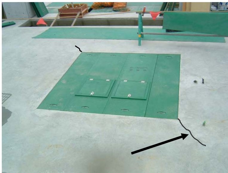
写真1 開口部のひび割れ(着色)
