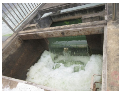
写真 3 シハヌークビル安定化池の放流水
