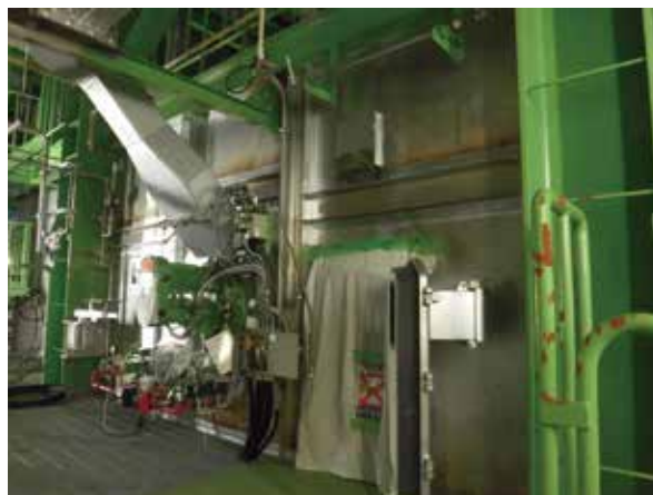
写真2 階段式ストーカ炉
