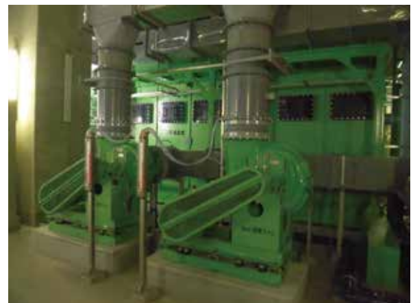
写真7 生物脱臭装置
