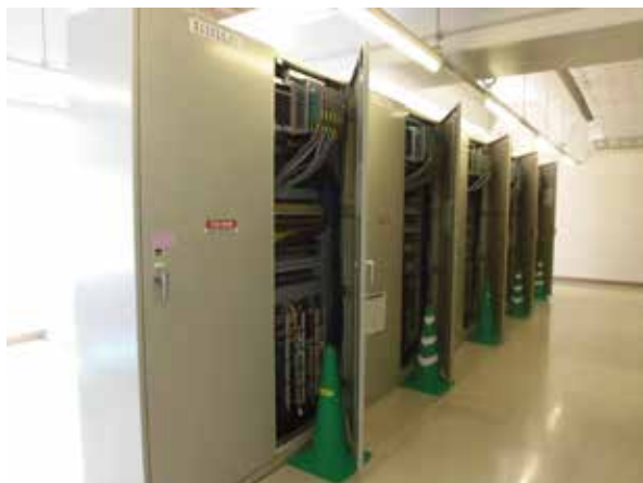
写真 8 補助継電器盤
