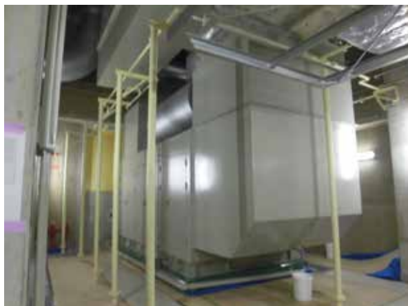
写真 9 自家発電設備
