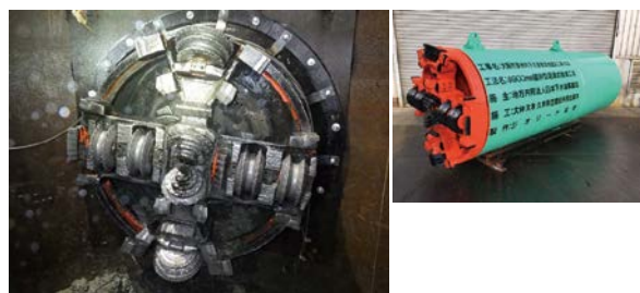
写真3 岩盤対応型ヘッド搭載の推進工法の採用（硬質地盤対応）
