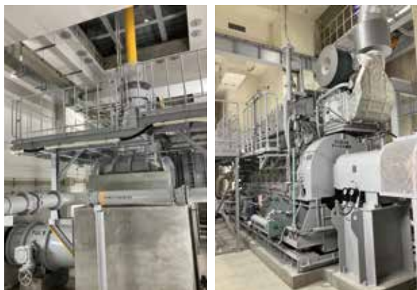
写真2 ポンプ設備（雨水ポンプ・原動機）
