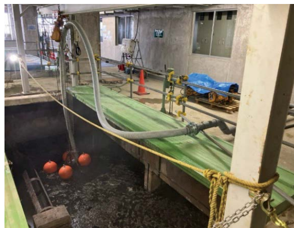
写真6 仮設スラム排水ポンプ
