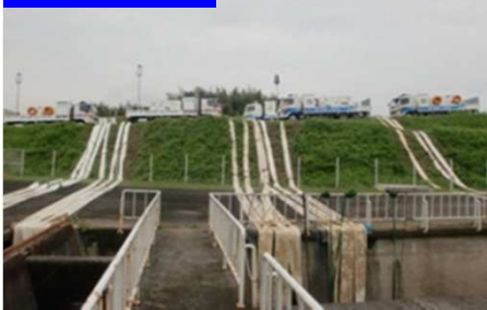
排水ポンプ車配備
