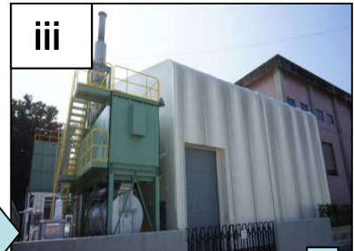
仮設乾燥施設全景 (処理能力30t/日)
