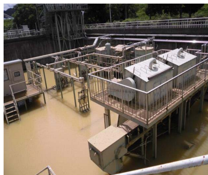
写真4 ポンプ場被災状況 (段畑汚水中継ポンプ場)
