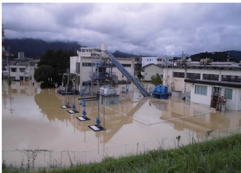
写真3 ポンプ場被災状況 (和久市ポンプ場)
