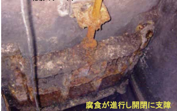
処理場施設の老朽化の例 (流入ゲート)
