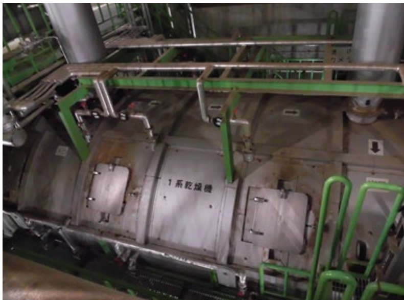
乾燥機 (既設新1号炉)
