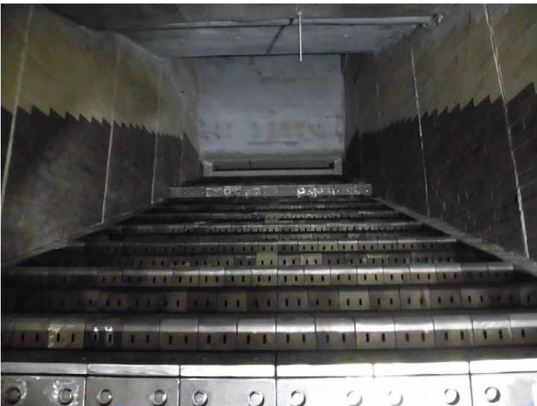
階段式ストーカ炉内部
