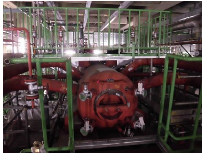
廃熱ボイラー
