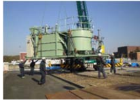
高沈ユニットの外観
