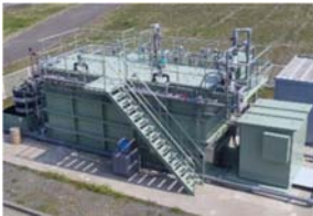
単槽式MBRユニットの外観
