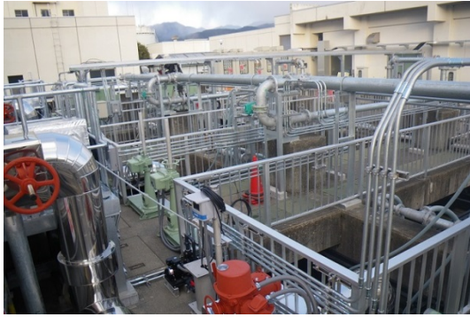
完成した実証研究施設
