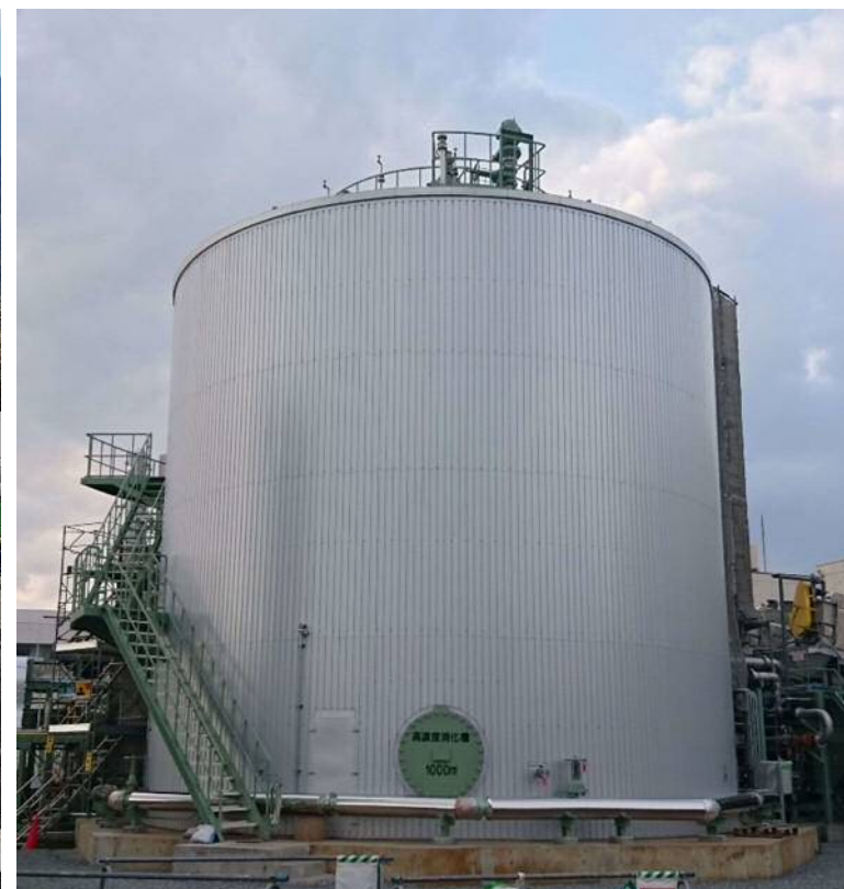
高濃度消化槽(有効容積1,000m 3 )
