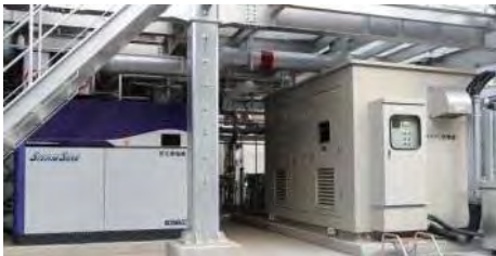
スクルー式蒸気発電機(左)とバイナリ発電機(右)
