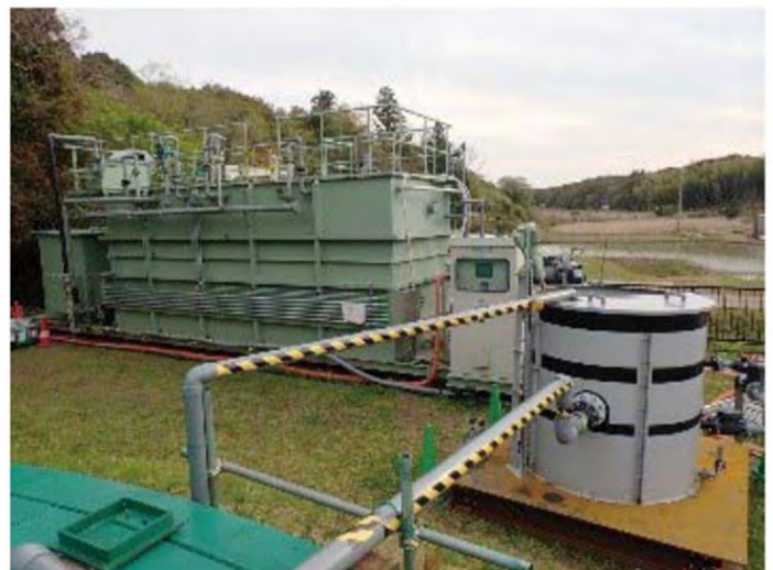
単槽式MBRユニットの設置状況例
