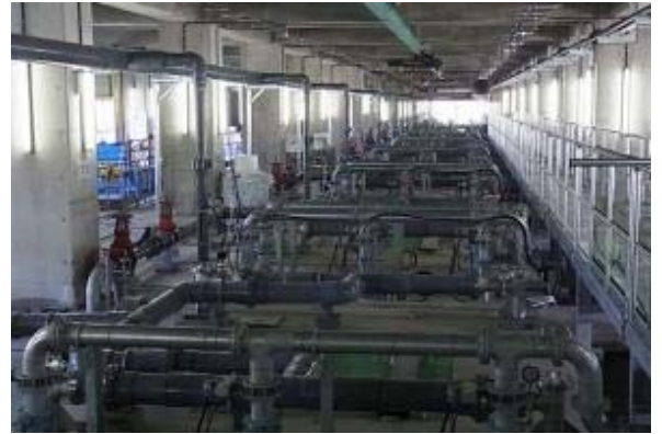
高速担体ろ床上部
