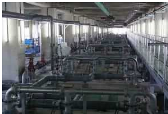
高速担体ろ床上部
