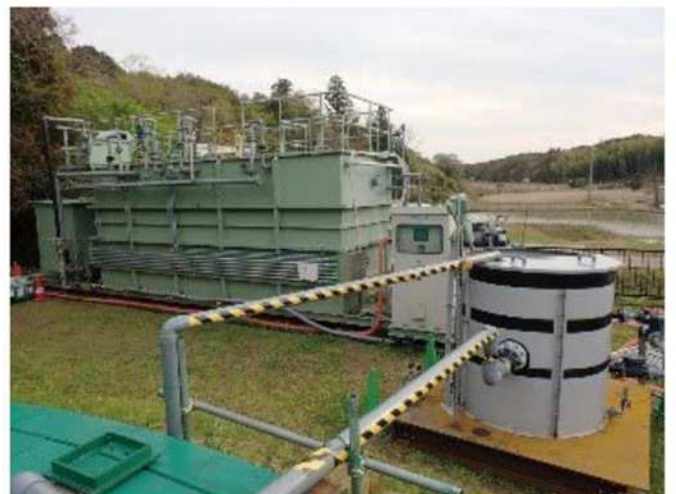
単槽式MBRユニットの設置状況例
