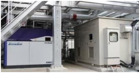
スクロ式蒸気発電機(左)とバイナリ発電機(右)
