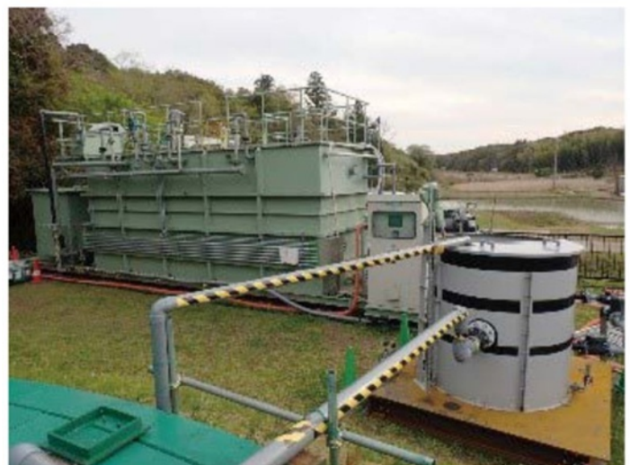
単槽式MBRユニットの設置状況例
