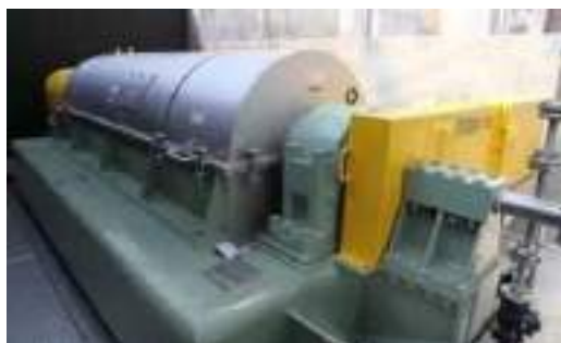
機内二液調質型遠心脱水機
