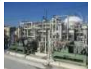
CO 2 分離・回収設備
