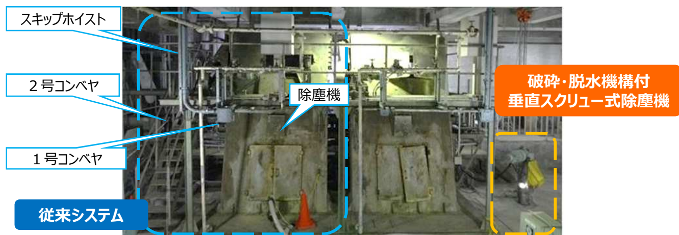
設置状況例(床上部分)
