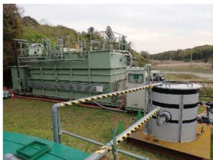
単槽式MBRユニットの設置状況例
