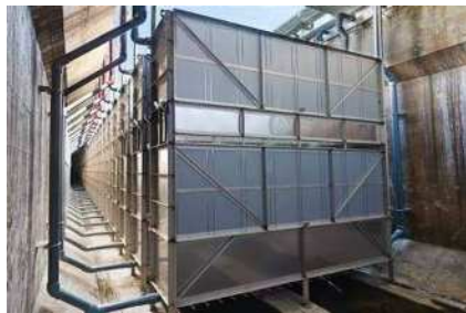
膜ユニットの設置状況例
