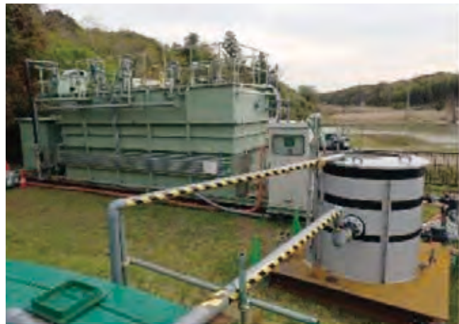
〈単槽式MBRユニットの設置状況例〉
