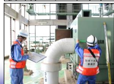
被災状況調査(送風機)
