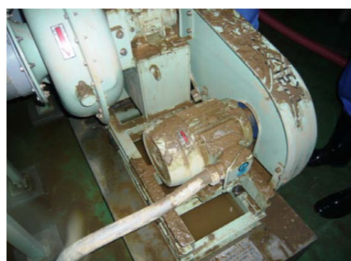
H29奈良県三郷町 立野汚水中継ポンプ場 被災調査状況
