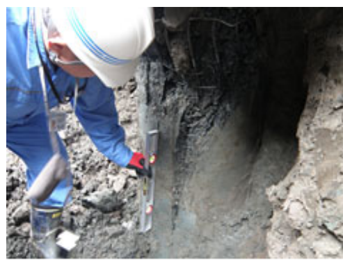
H28熊本地震 被災調査状況
