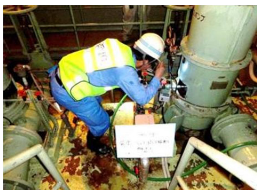
H28岩手県宮古市 宮古雨水ポンプ場 被災調査状況
