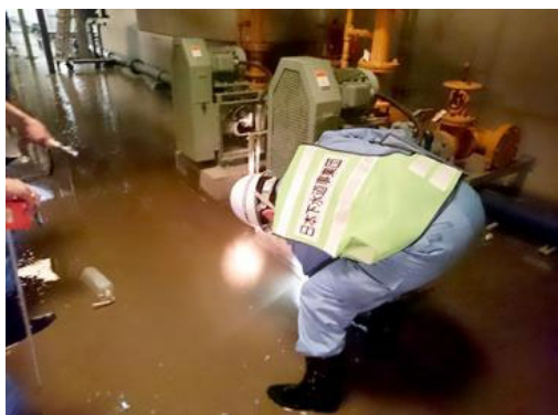
H28熊本地震 被災調査状況
