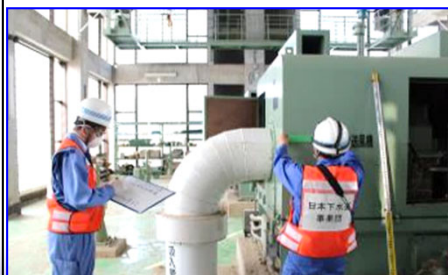
現地における送風機被災状況の確認
