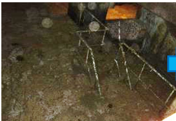
被災直後（汚泥、ヘドロの堆積）
