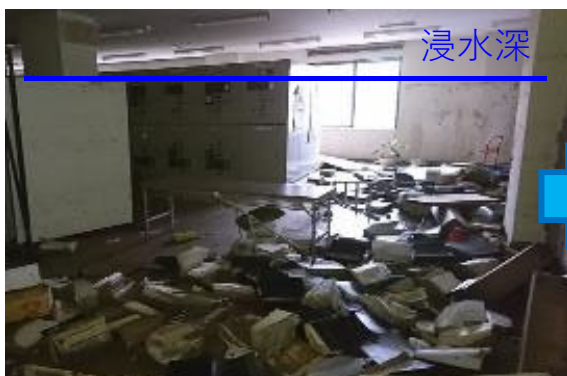
被災直後の電気室（1階）
