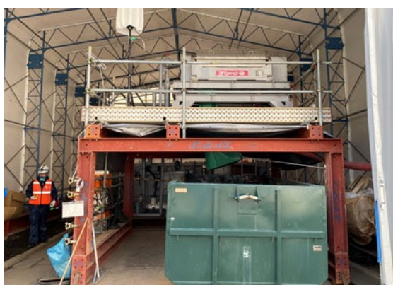
汚泥処理用の仮設汚泥脱水機
