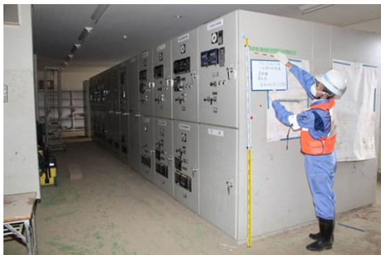
管理棟 1 階電気室
