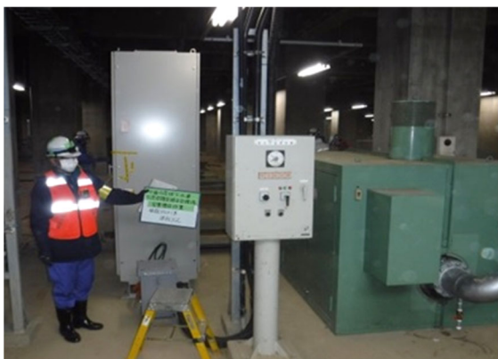
水処理曝気用の仮設送風機
