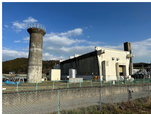
北白土第一ポンプ場
